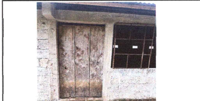
foto 4: se observa en una de las aulas del modulo 2, el deterioro de las puertas.
