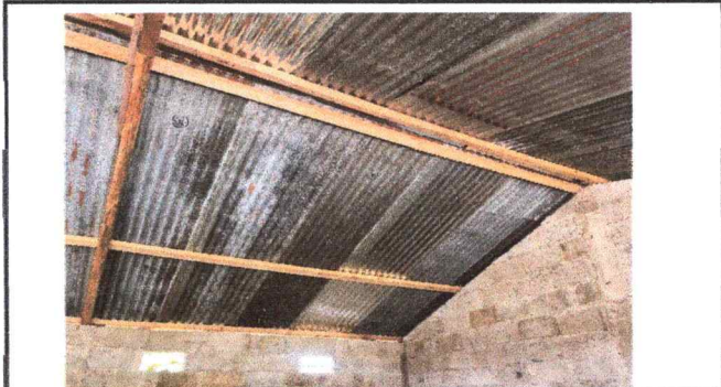
Foto 1: se observa el deterioro de las laminas portante en el modulo 2
