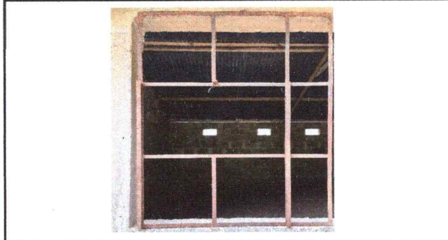
foto 2: se observa el deterioro de las ventanas en una de la aulas del modulo 2
